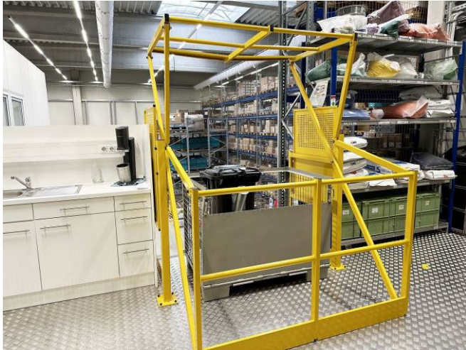
Abb. 3: Die mit Mahlgut gefüllte Materialtonne wird mit Hilfe eines Gabelstaplers und eines ausgeklügelten Sicherheitsmechanismus ins Obergeschoss zur zentralen Materialversorgungsanlage gehievt.
